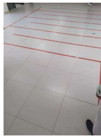
Figura 36: Ausência de piso tátil
