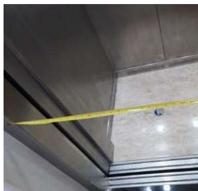
Figura 47: Elevador com dimensão interna inadequada e sem corrimão
