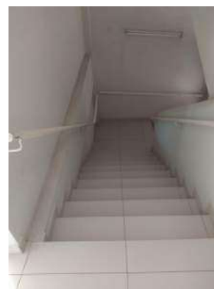
Figura 33: Escada sem sinalização nem corrimão inferior
