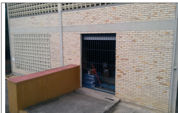
Ausência de câmeras na área de carga e descarga.
